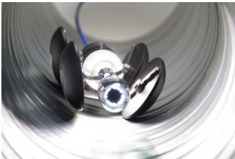
Abb. 12: Selbst wenn der Kamerawagen während der Inspektion kippt, kann er im Rohr weiter geschoben werden.
