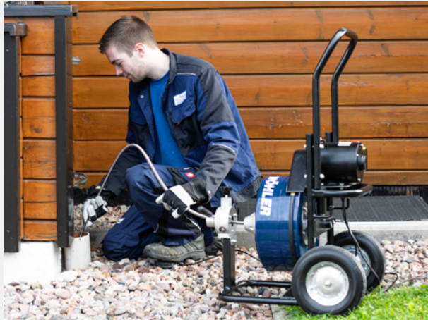
Auch im Außenbereich können Abflüsse mit der Wöhler RM 400 Rohrreinigungsmaschine gereinigt werden.
