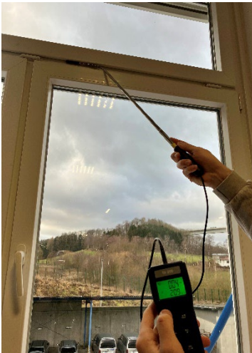
Fig. 51 Lekdetectie op het raamkozijn
