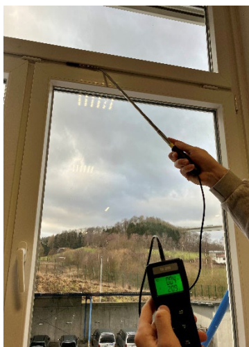
Fig. 39 Rilevamento delle perdite sul telaio della finestra
